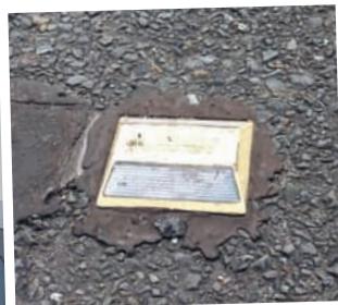
A road stud
